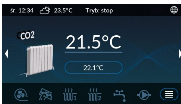
Ilustracja 22: Ekran obwodu CO.2
